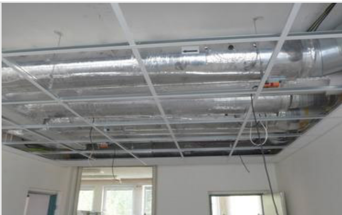
Obr. 6: regulační boxy VZT pod stropem šatny
