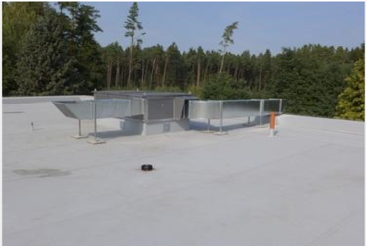
Obr. 7: jednotka VZT na střeše
